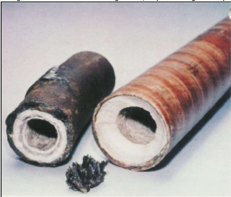
Rør med afsætning af scale.
